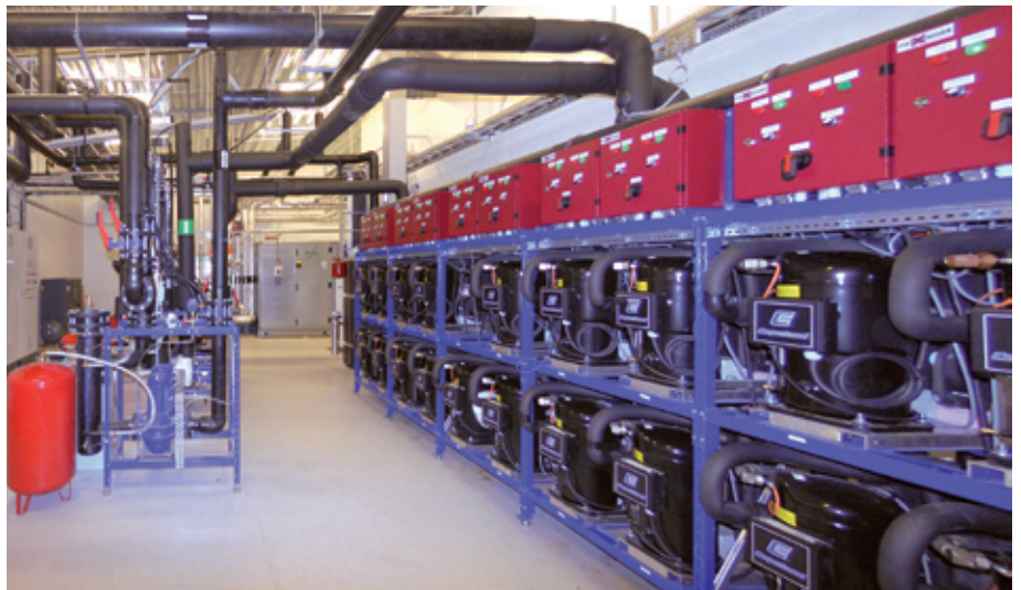
▲ Die total 19 Module (10 Tiefkühlung / 9 Normalkühlung) benötigen nur einen geringen Platzbedarf und sind schnell installiert
