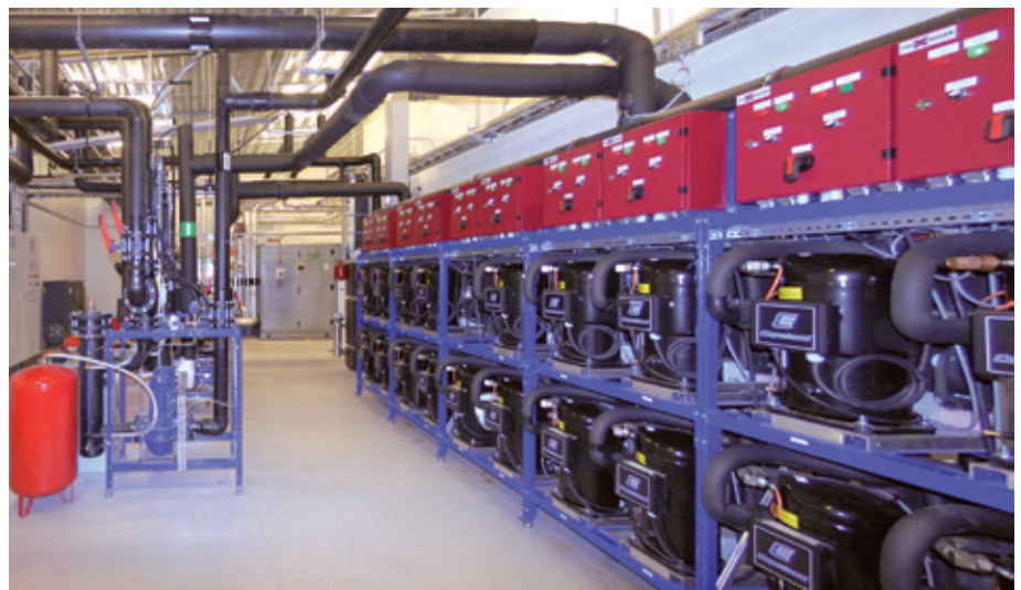
▲ Die total 19 BMS tolerançe Module (10 Tiefkühlung / 9 Normalkühlung) benötigen nur einen geringen Platzbedarf und sind schnell installiert
